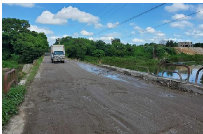
Ilustración 4: Puente en mal estado
