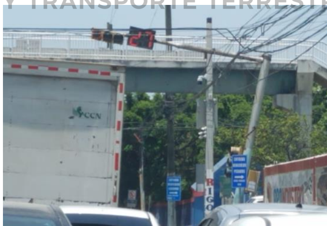
Ilustración 33: Torre semafórica del Sur inclinada
