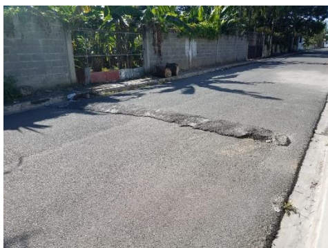
Imagen 2: Lomo en mal estado.
